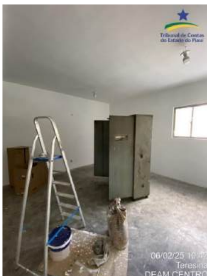
Figura 4 Gabinete das delegadas na DEAM/Centro em reforma após incêndio
