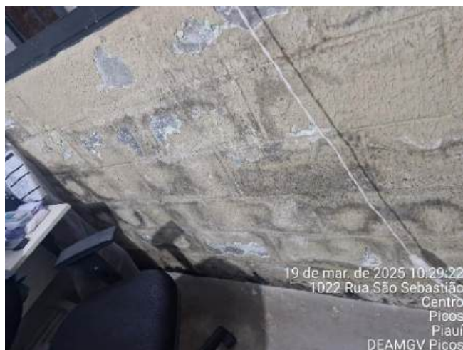
Figura 8 Parede da sala de cartório da DEAMGV em Picos com infiltração e mofo.
