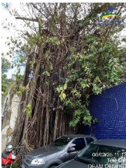
Figura 6 DEAM/Centro: Árvore na parte externa que compromete a estrutura do prédio
