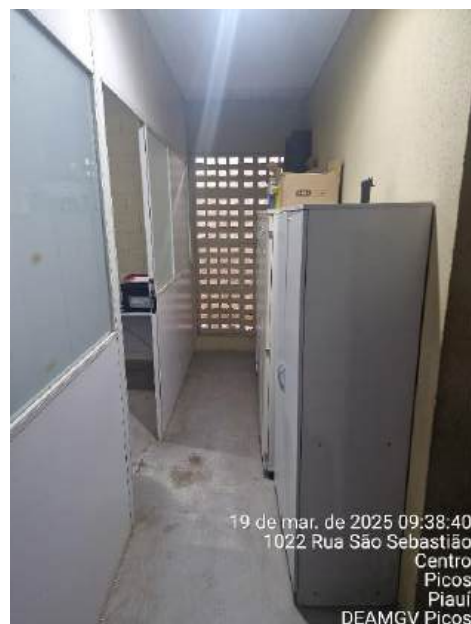
Figura 9 Na Delegacia Regional de Picos, os armários foram postos no corredor, para abrir espaço nas salas para acomodar os profissionais, em prejuízo da acessibilidade.
