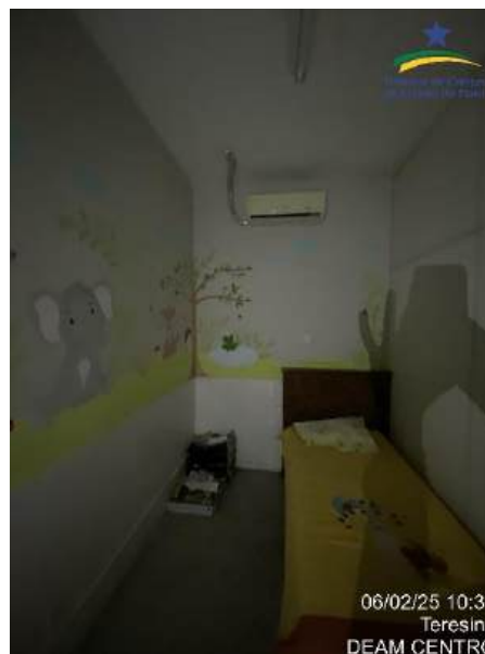
Figura 5 DEAM/Centro: Sala de acolhimento de crianças sem iluminação, por problemas na rede elétrica
